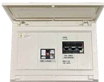
切替盤 (切替機100A+ELCB75A)
