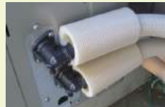
ヒートポンプ接続部
